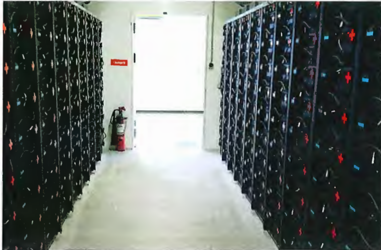
Der beim Netzbetreiber Arbon Energie realisierte Batteriespeicher wurde in ein bestehendes Gebäude integriert. (Foto: ads-tec Energy GmbH)
